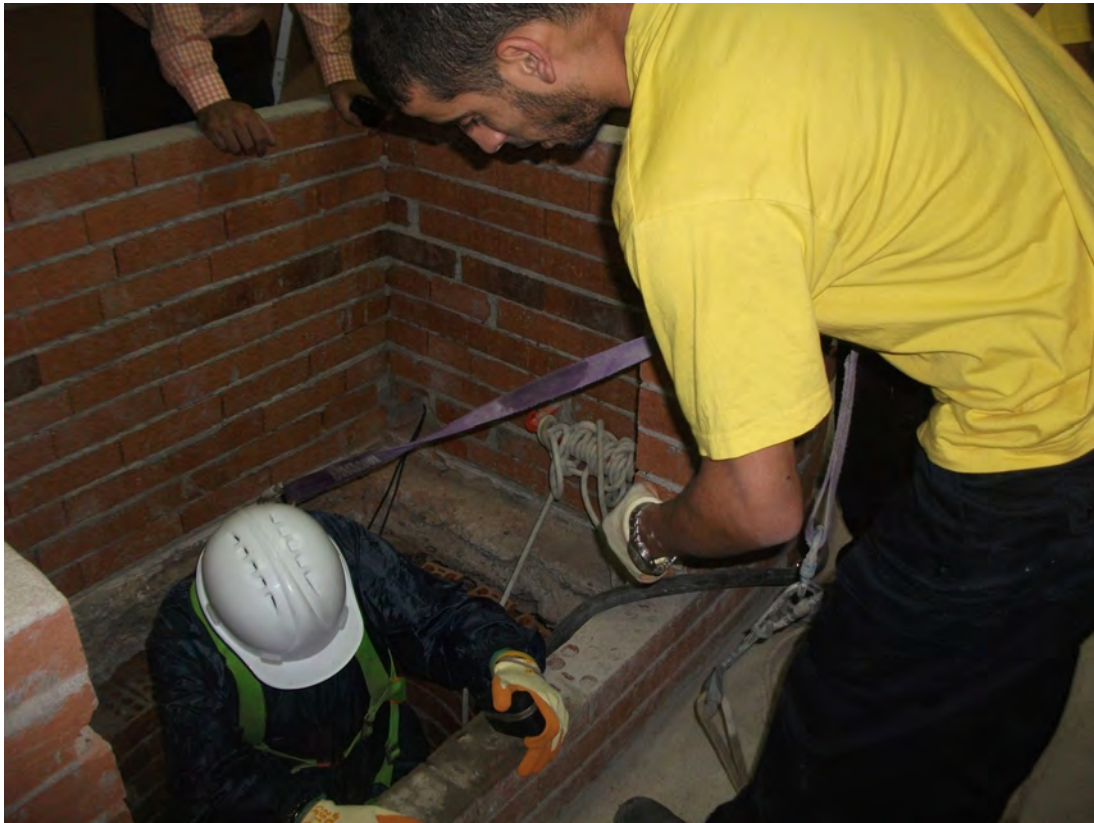
Fig. 25: Descenso indebido de un operario a través de un pozo.
