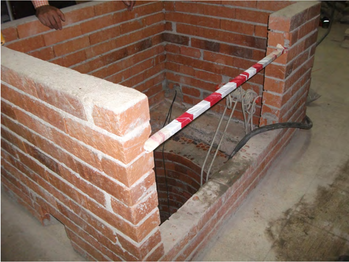
Fig. 27: Peto de protección perimetral, dispuesto en el perímetro del pozo.
