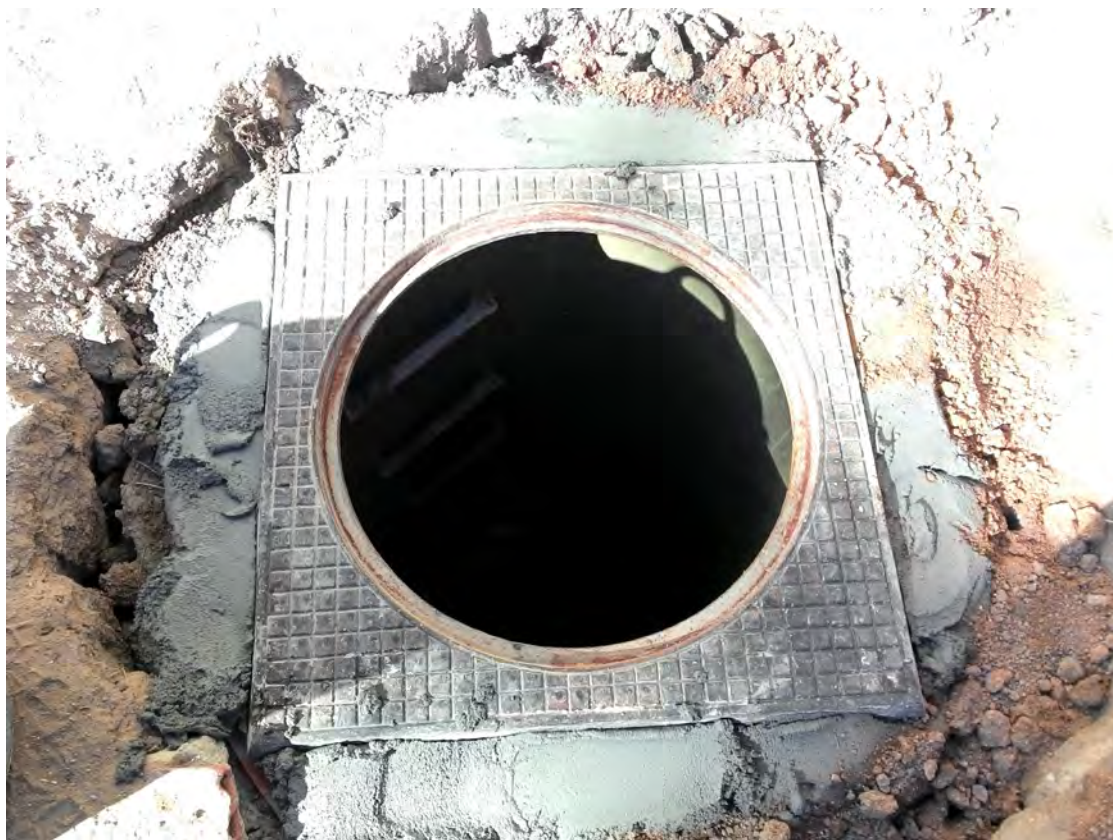
Fig. 31: Tapa dispuesta en la boca de acceso a un pozo que conduce a una galería de saneamiento.
