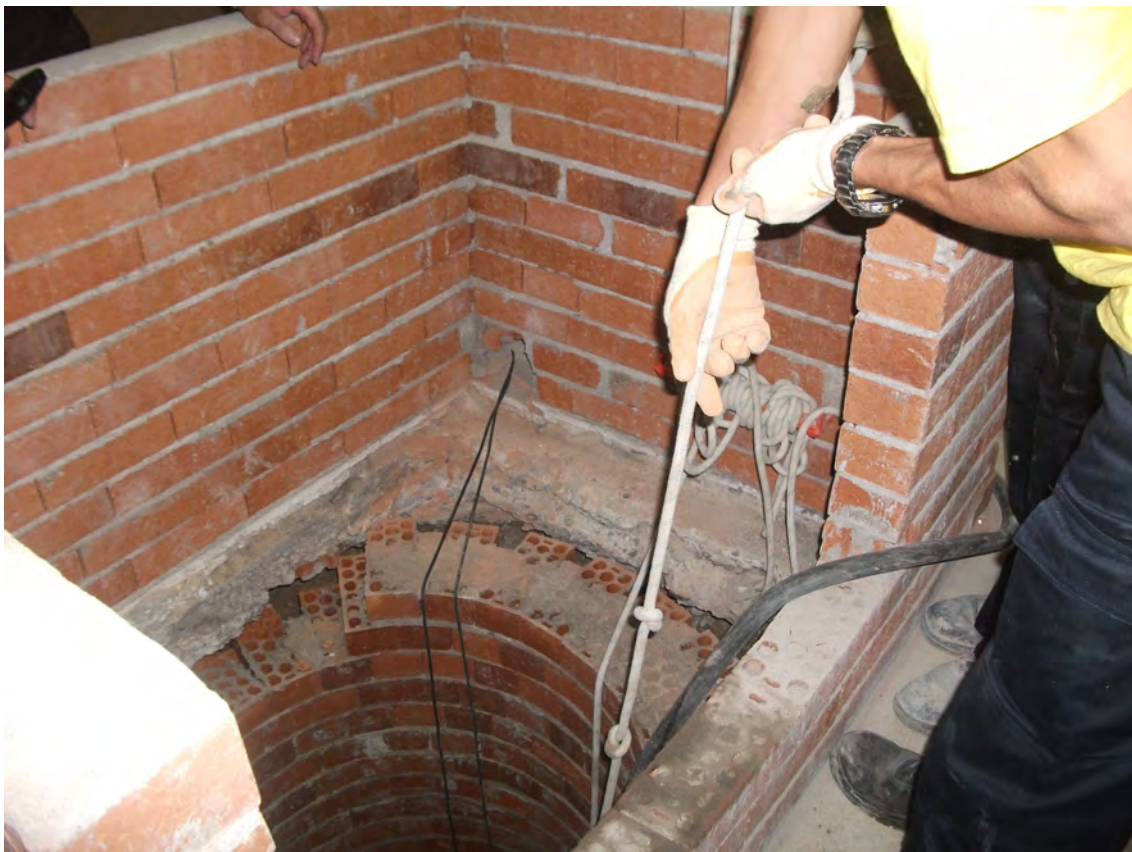
Fig. 26: Descenso indebido de material a través de un pozo. Se ha de emplear el maquinillo y el operario ha de contar con protección contra la caída.
