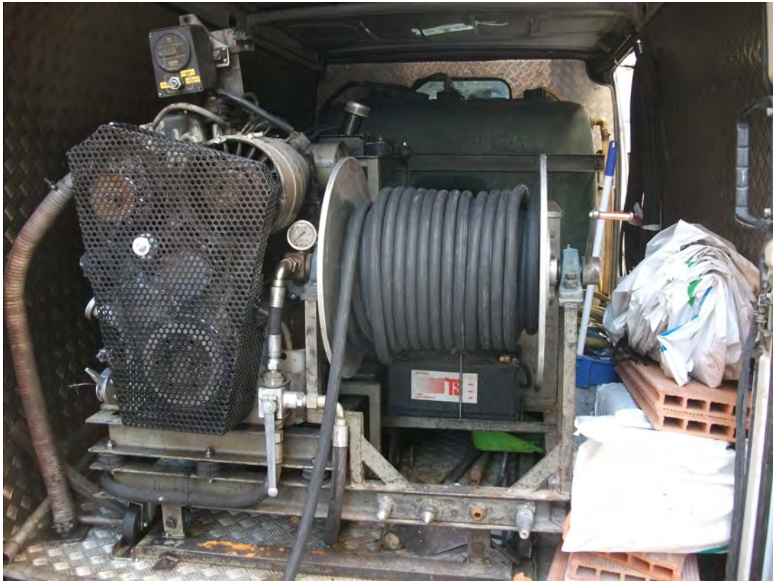
Fig. 14: Equipo de generación diésel en vehículo convenientemente acondicionado.
