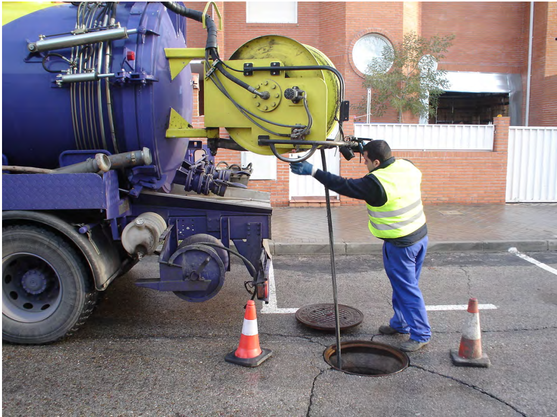
Fig. 5: Operario introduciendo el dispositivo de agua a presión en el interior de una alcantarilla para su limpieza, siguiendo una práctica habitual pero incorrecta: el operario no está protegido contra la caída.
