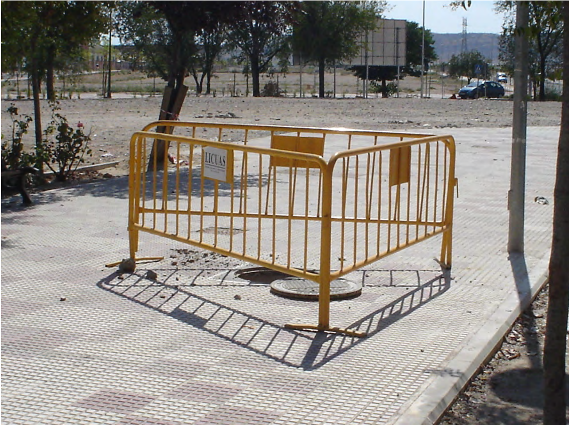
Fig. 3: Vallas delimitando perimetralmente un pozo abierto.
