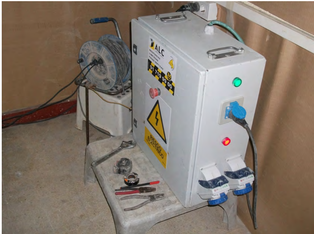
Fig. 23: Cuadro eléctrico para suministro de energía, con su transformador de seguridad de 24 V (abajo y su toma de tierra).
