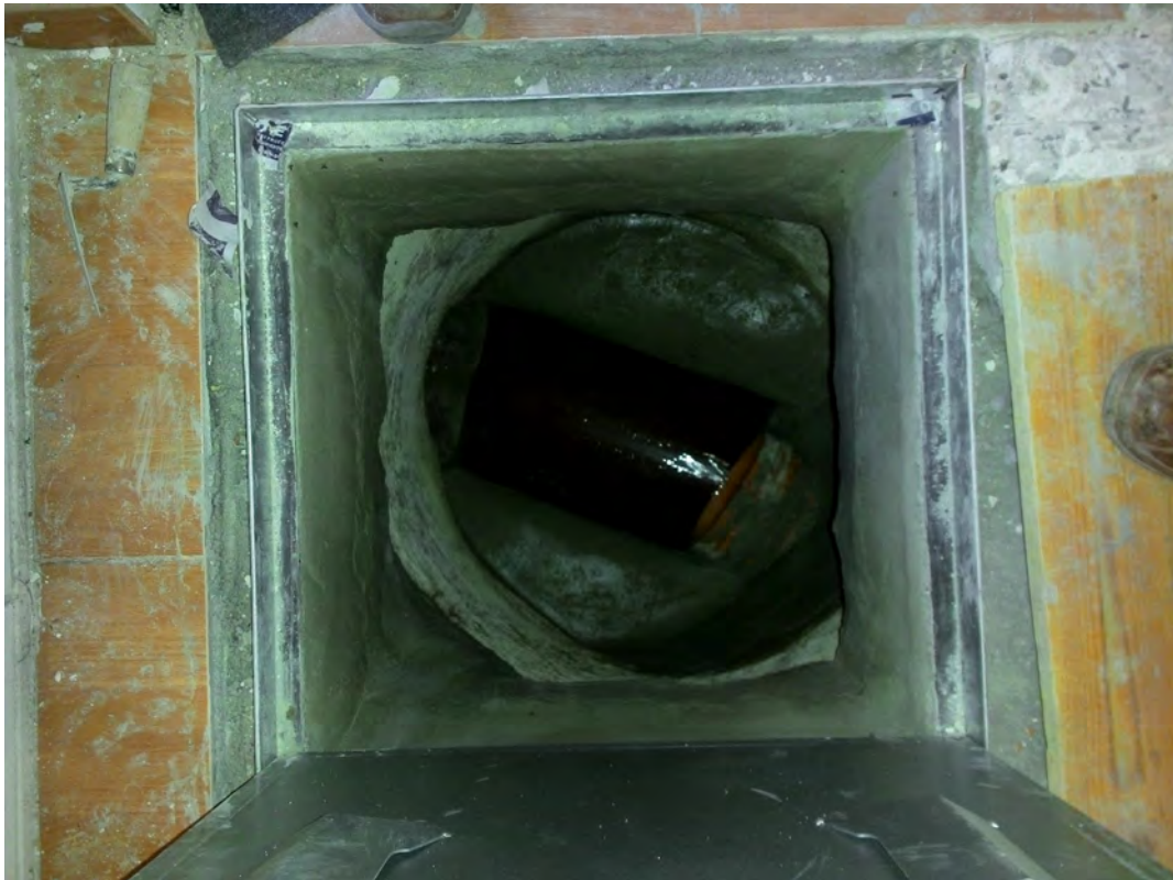
Fig. 8: Tapa abierta en una arqueta, para acceso a una conducción al objeto de realizar tareas de limpieza y desatranco.
